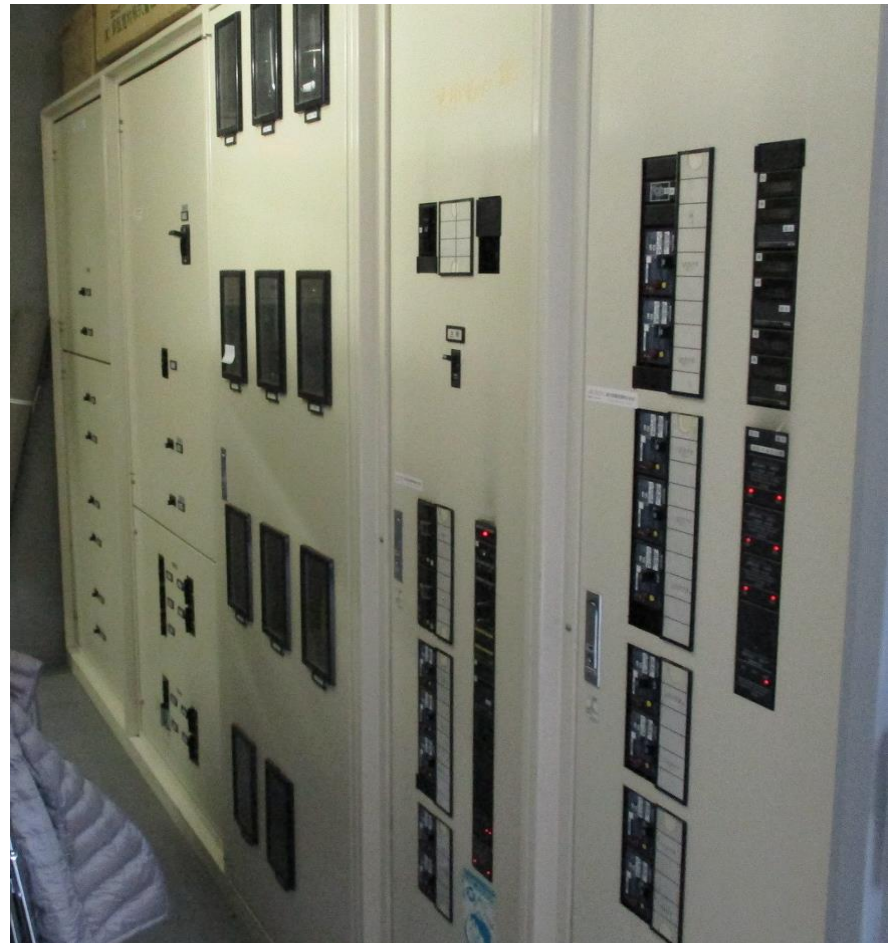
動力分電盤(手前)
