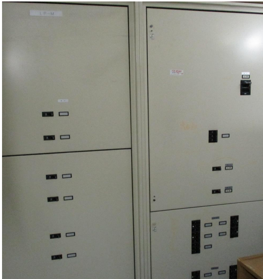
引込開閉器盤
