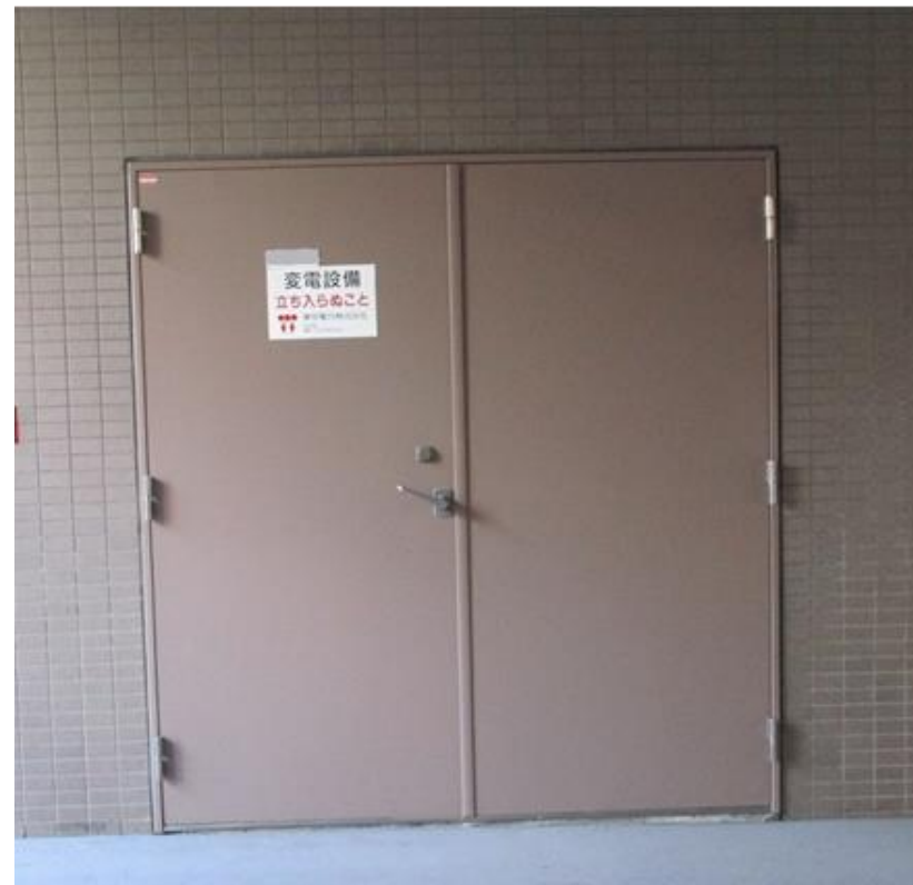
電力会社借室
