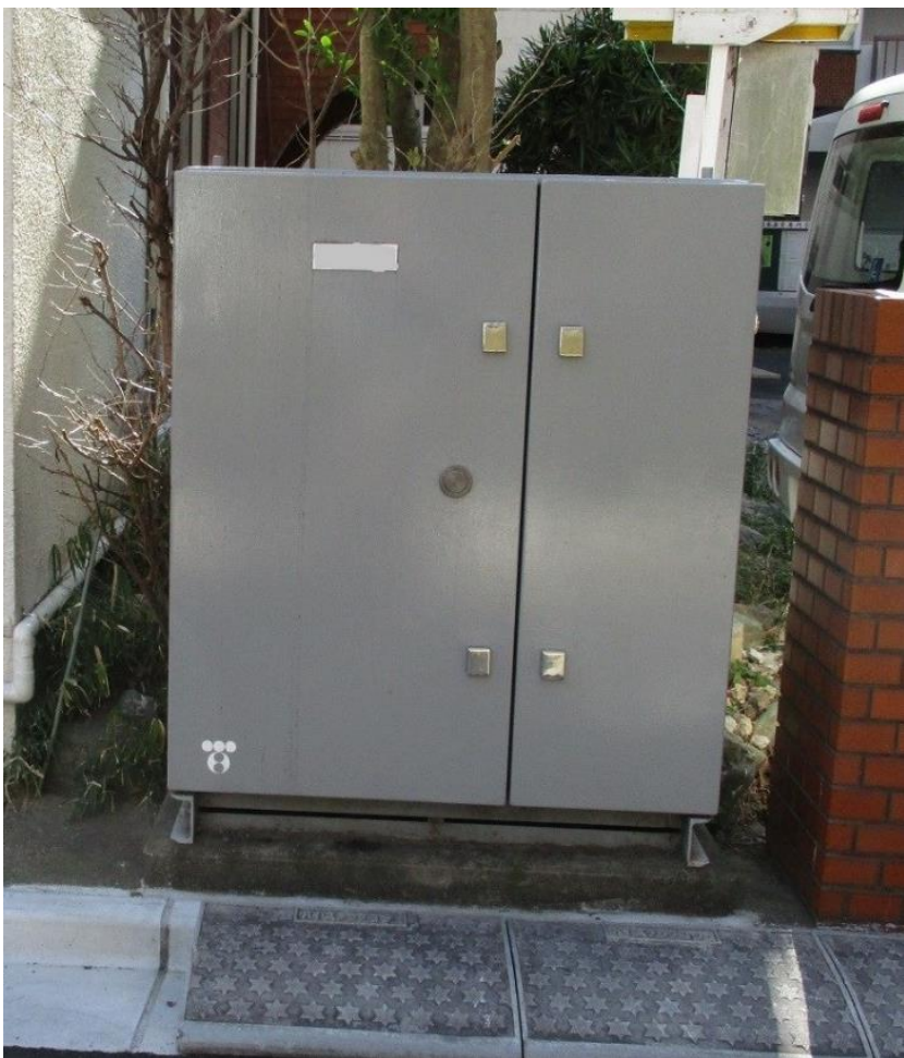
区分開閉器・高圧キャビネット(地中用)
