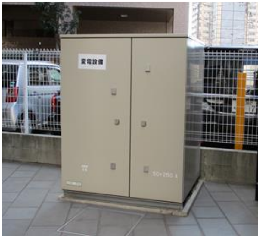
集合住宅用変圧器
